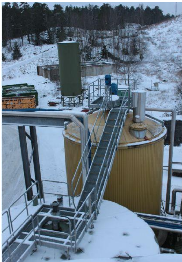
Biomasse urbaine – installation de biométhanisation alimentée par de la biomasse agricole – Source : Dominic Lapointe
